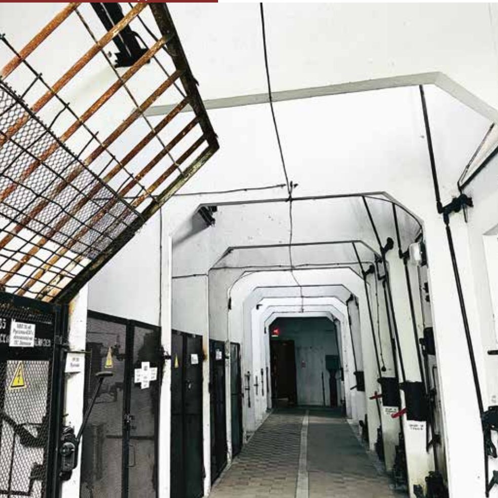
На подстанции «КЭТ»
