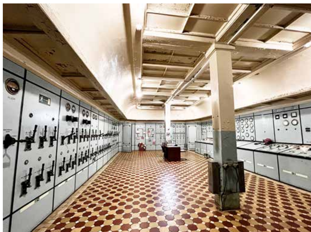
Помещение подстанции «КЭТ»
