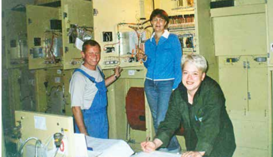
Начальник смены ПС-220-110-10 кВ «Районная», 2004 год
