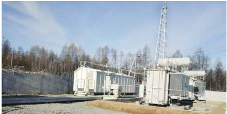
Новая подстанция «Шахтаум» начала свою работу в ноябре
