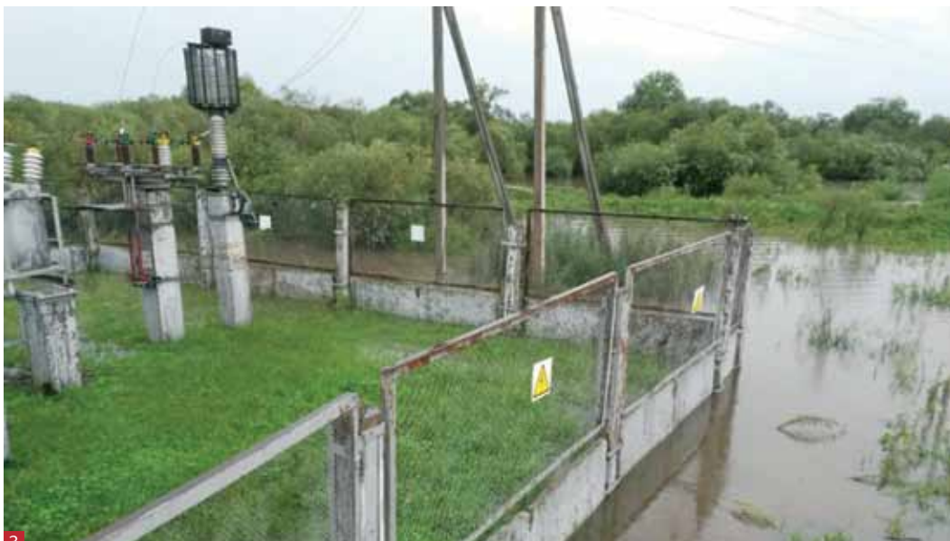
3-4. На подстанции в Студгородке вода поднялась до критического уровня – около полутора метров.
