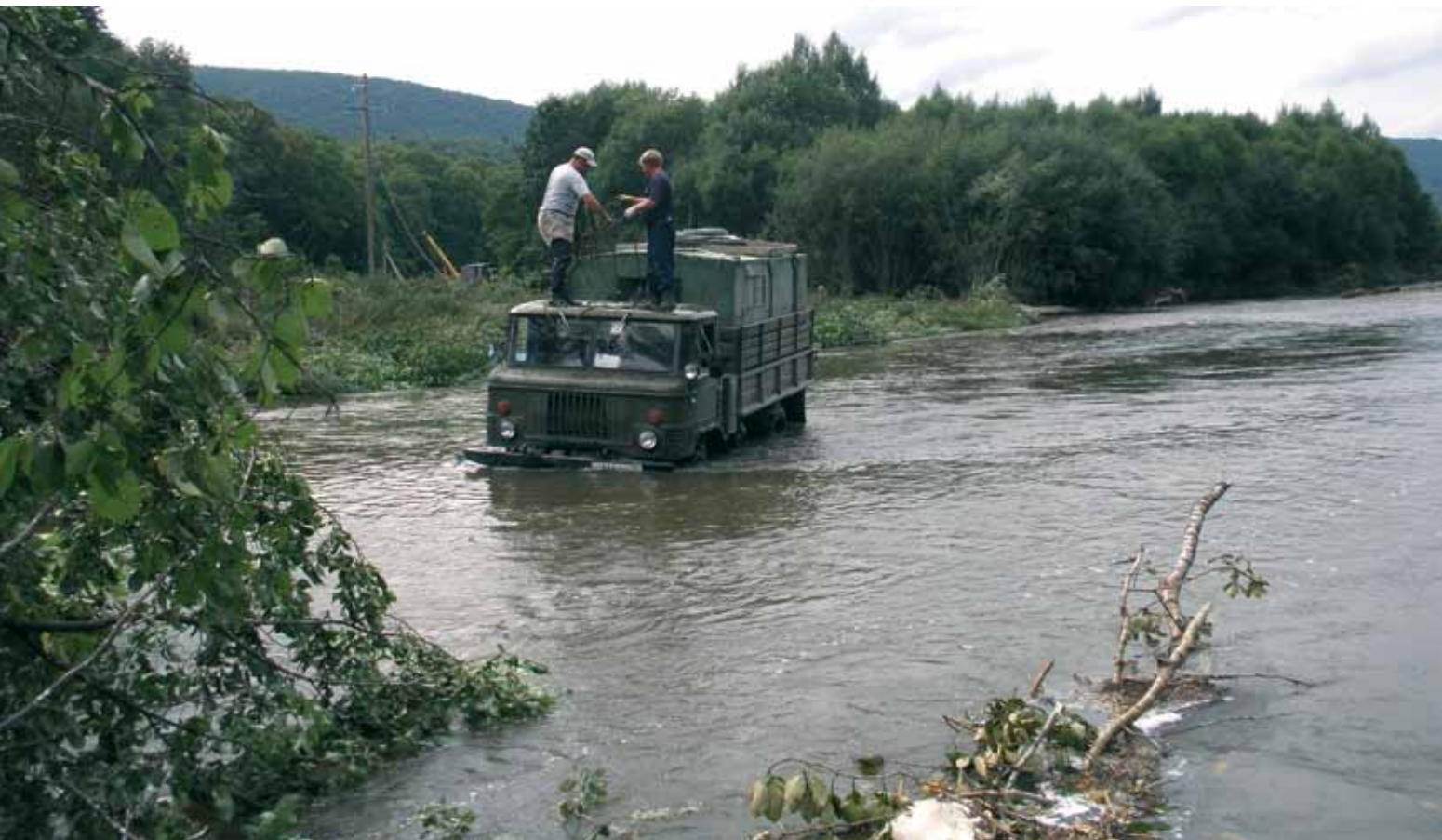
Монтаж провода на участке ВЛ-10 кВ Ф-17 Варваровка – переход через р. Арсеньевка
